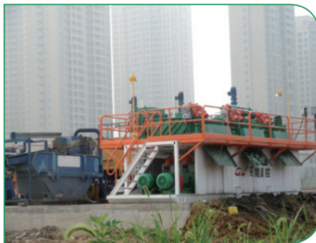
河道清淤工程固液分离系统
